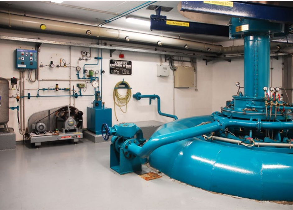
Kraftwerk Bodendorf, Maschinenhalle
