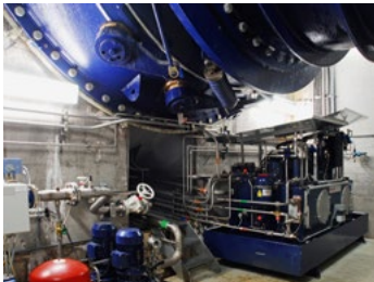
Turbinenraum mit Reglereinrichtungen
